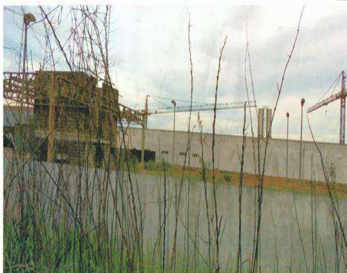
Chantier de construction de l'HG de Sibiti en arrêt depuis 2016. Photo de Novembre 2022. Source Enquête de PCQVP
