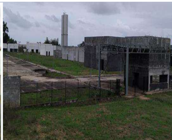
Chantier de construction de l'HG de Loango en arrêt depuis 2016, Photo de 2021. Source Enquête de PCQVP
